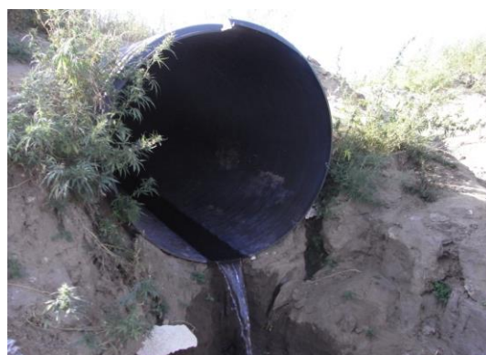
写真 6-5 アルミニウム工業付近の排水口
