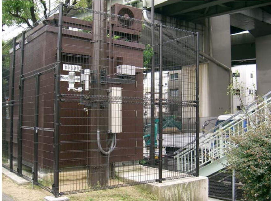
写真 2.5.1 国道 43 号沿道に設置されている市岡元町局
